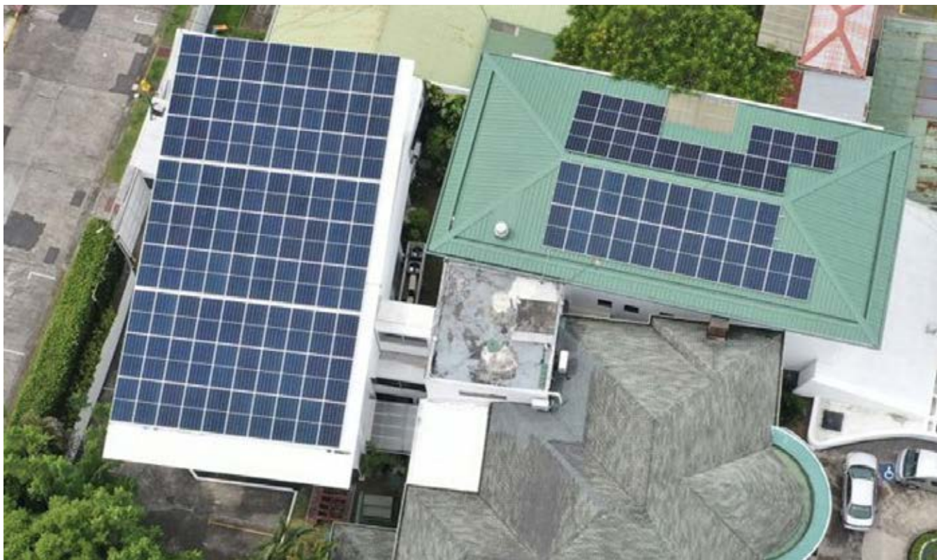
Vista aérea dos painéis fotovoltaicos nas instalações da Corte.
